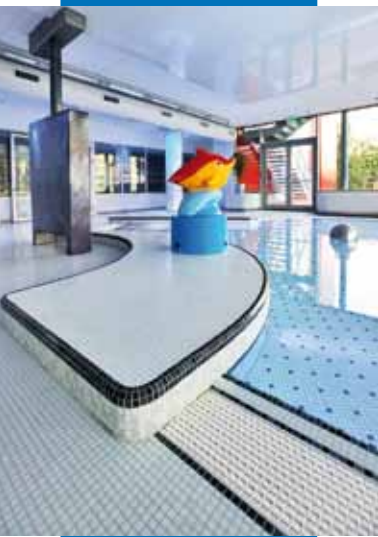
Bir yüzme havuzunda cam mozaiklerin, su ile 1:1 oranında seyreltilmiş Isolastic ve Adesilex P10 karışımı ile uygulanması Aquacentrum Pardubice, Pardubice, Çek Cumhuriyeti
