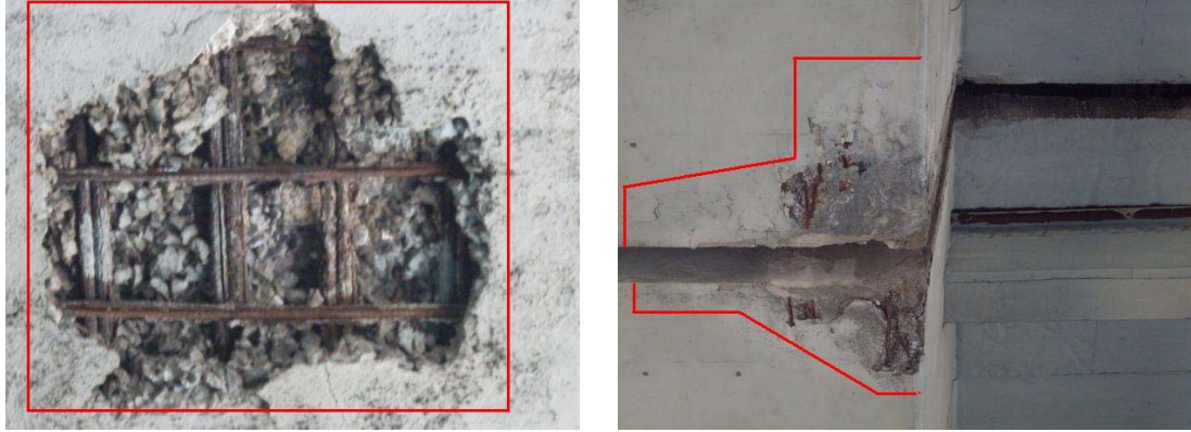
Şekil 18. Onarım öncesi hasarlı bölgelerin işaretlenmesi
