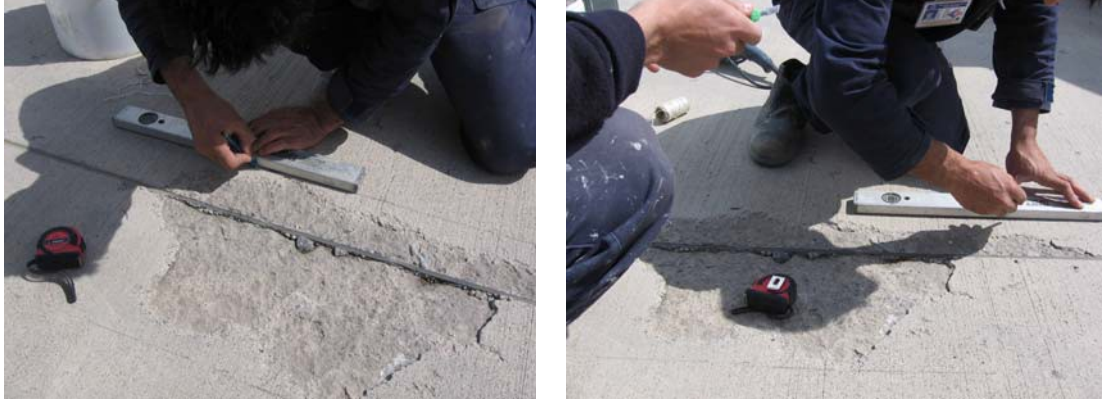
Şekil 3. Onarım öncesi hasarlı bölgelerin işaretlenmesi
